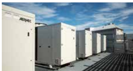
Fem Aermec NRK luft-vatten värmepumpar används för kyla, värme och varmvattenproduktion.
