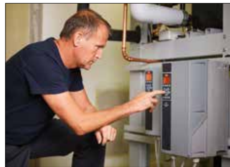
Webbaserad styrning och övervakning som både Kent och handlaren har tillgång till. Ovan en frekvensomformare till en av kylkompressorerna vars funktion kan kontrolleras via webben.
