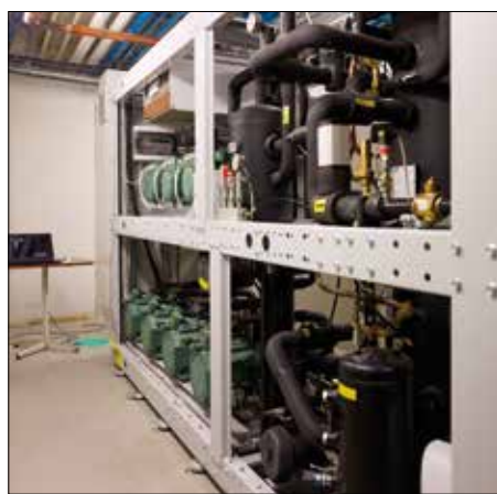
Kent fick utbilda sig hos SCM Frigo för att kunna räkna fram behov och dimensionering på anläggningen som betjänar åtta kyl- och två frysrum.
