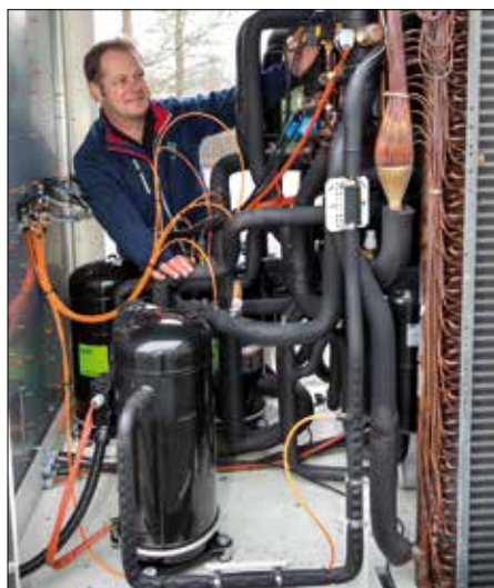
Jouni Sotti, Gunnar Karlson Sverige AB, Karlshamn har driftsatt anläggningen som drivs med 3 kompressorer och ger full värmeeffekt ner till -15°C med bibehållen verkningsgrad.
