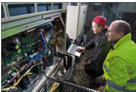
Systemet är uppkopplat mot central övervakning med Toshiba Smartmanage BMS-SM1280 där hela konfigurationen kan regleras. Alla parametrar kan justeras eller låsas.
