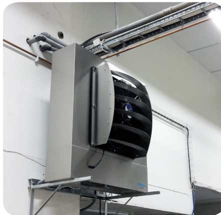
En av Munters två luftbefuktare HM3 hos Umpac.
