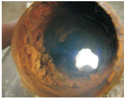
Galvaniserade kallvattenrör innan Bauer vattenbehandling har installerats
