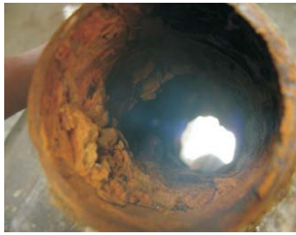
Galvaniserade kallvattenrör innan Bauer vattenbehandling har installerats
