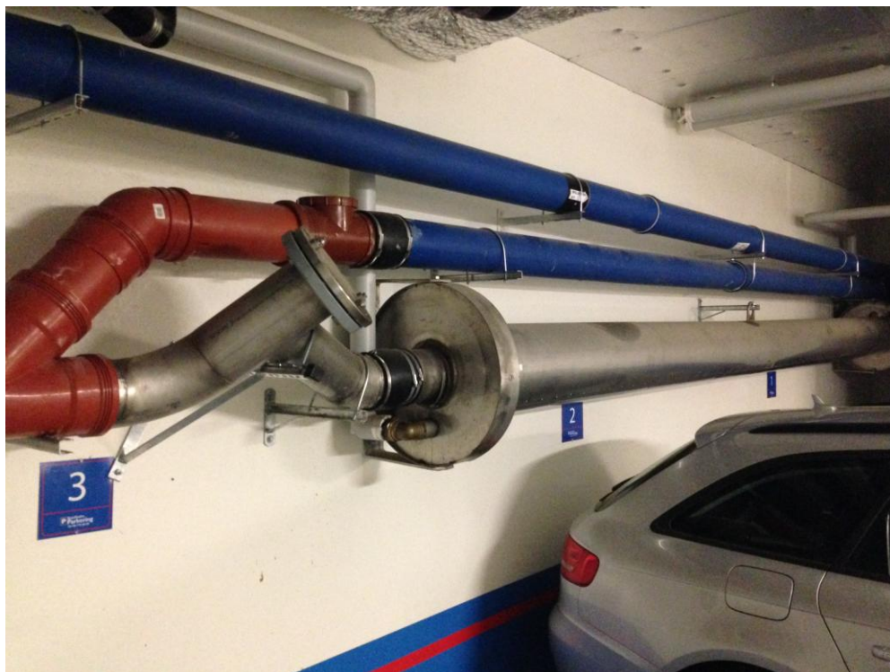
Figur 7.2 Liggande rörvärmväxlare i Gubbängen (foto Anders Nykvist).
