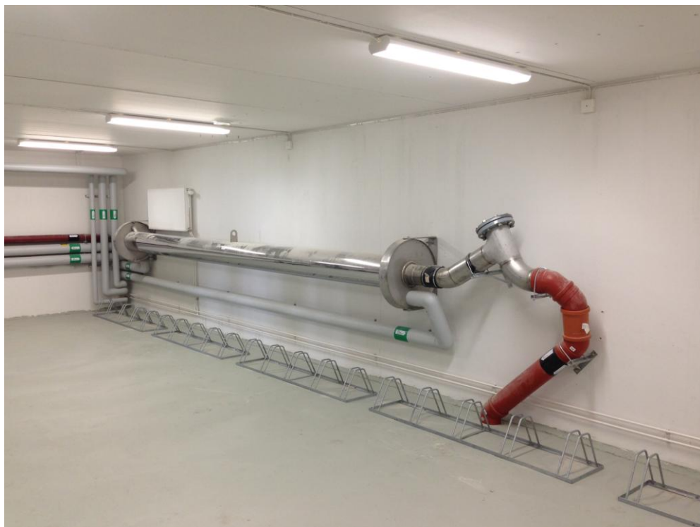
Figur 7.1 Liggande rörvärmväxlare i Ängby Park (foto Anders Nykvist).
