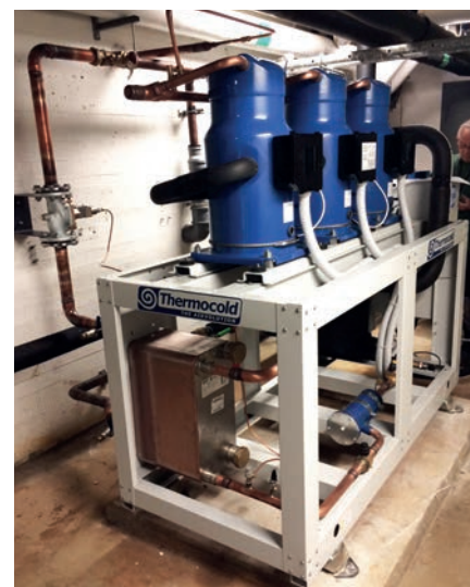
Ovan syns Sune Johansson, Kyl & Tvättservice i Trollhättan, vid MTA-installationen hos GKN.
